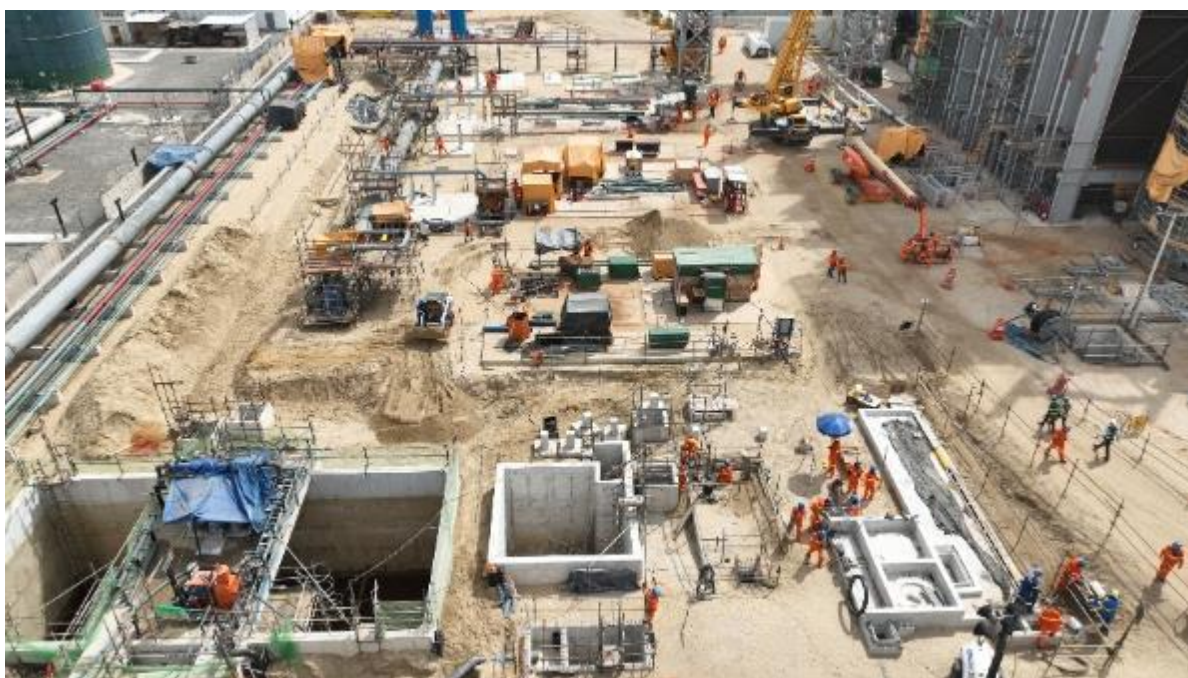
Figura 6-18: Planta de neutralização e SAO.
